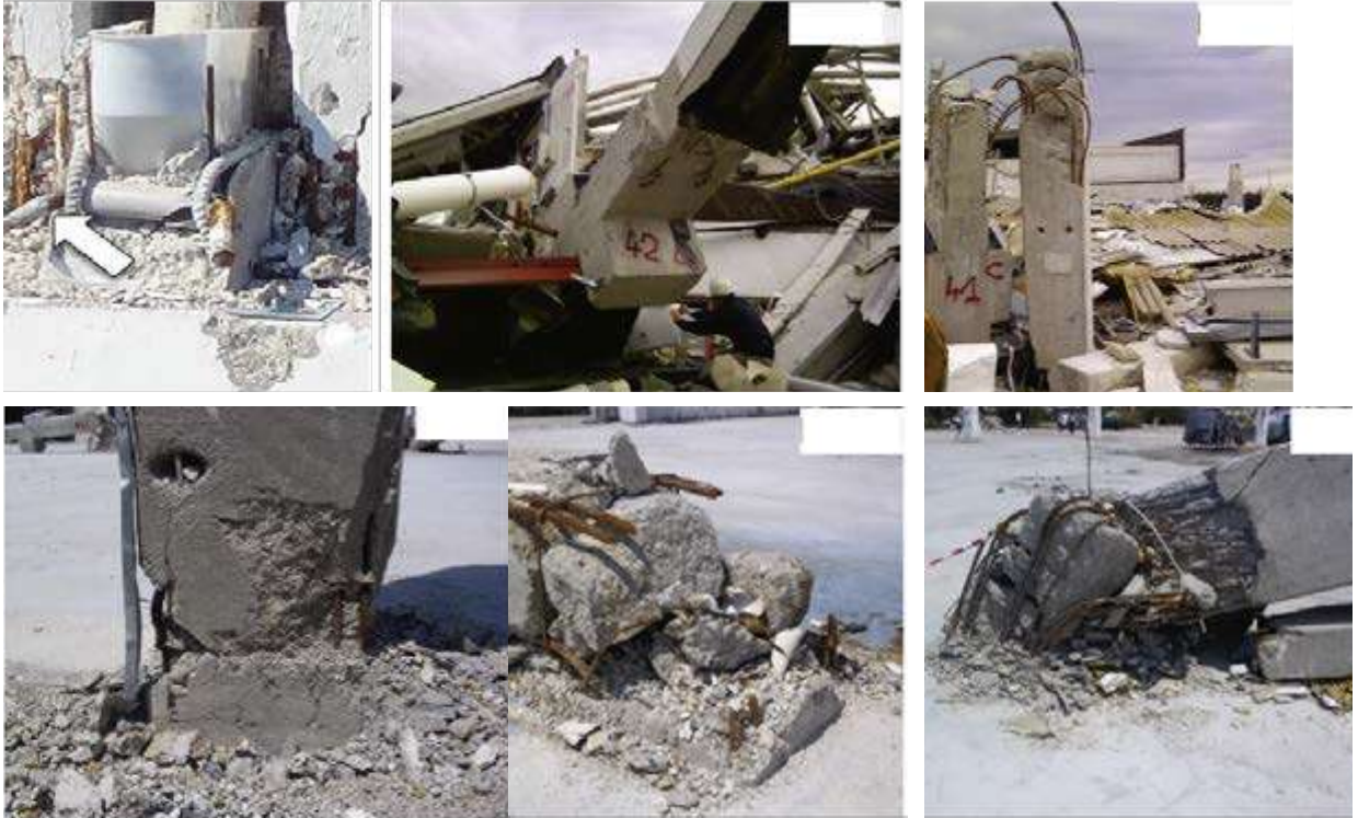
FOTOĞRAF 14. Deprem Etkileri Nedeniyle Oluşan Zemin Kat Kolon Hasarları (Saatcioglu vd., 2001)
