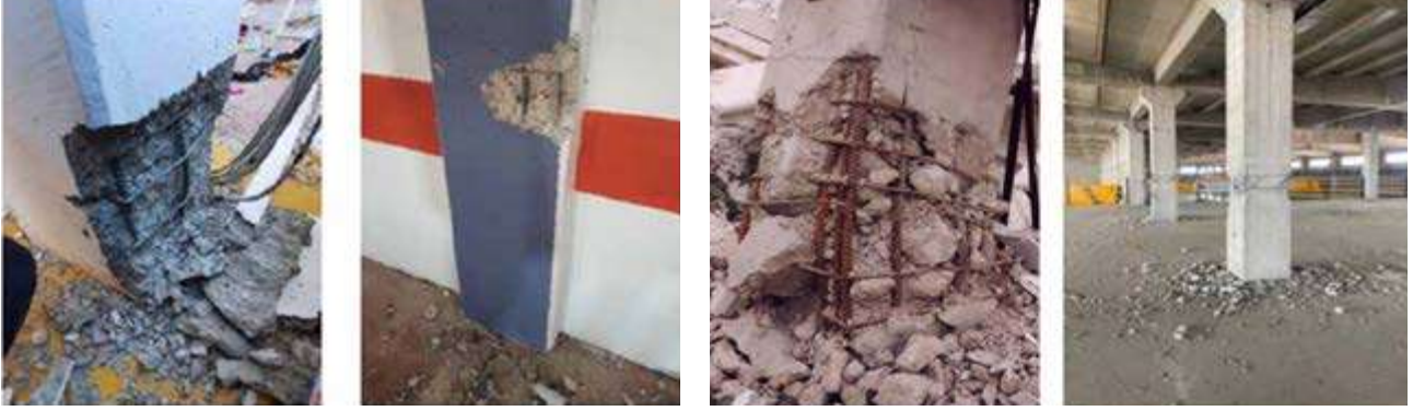
FOTOĞRAF 13. Deprem Etkileri Nedeniyle Oluşan Zemin Kat Prefabrik Kolon Hasarları (Yüksel vd., 2023)
