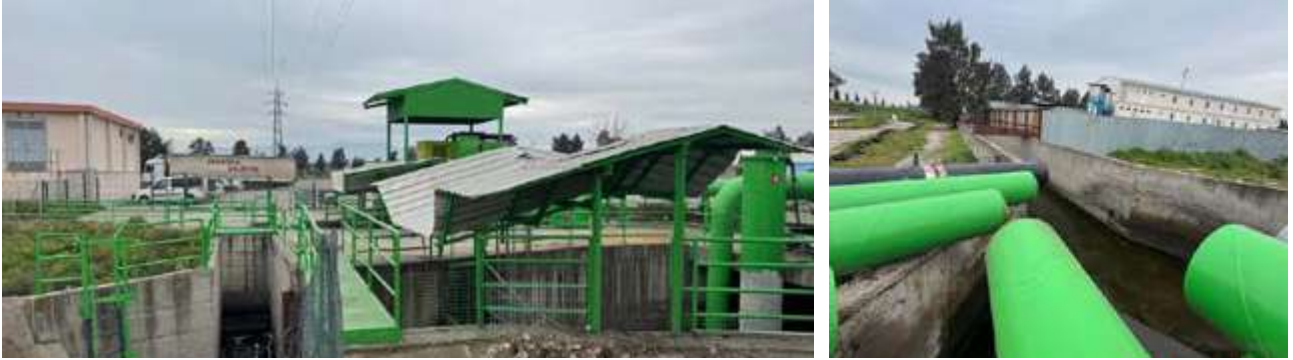
FOTOĞRAF 12. Yağmur Suyu Uzaklaştırma Pompa İstasyonları
