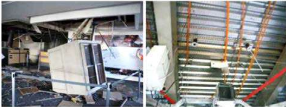
FOTOĞRAF 24. Deprem Etkisi Nedeniyle Oluşan HVAC Sistem Hasarları (Miranda, Mosqueda, Retamales, & Pekcan, 2012)
