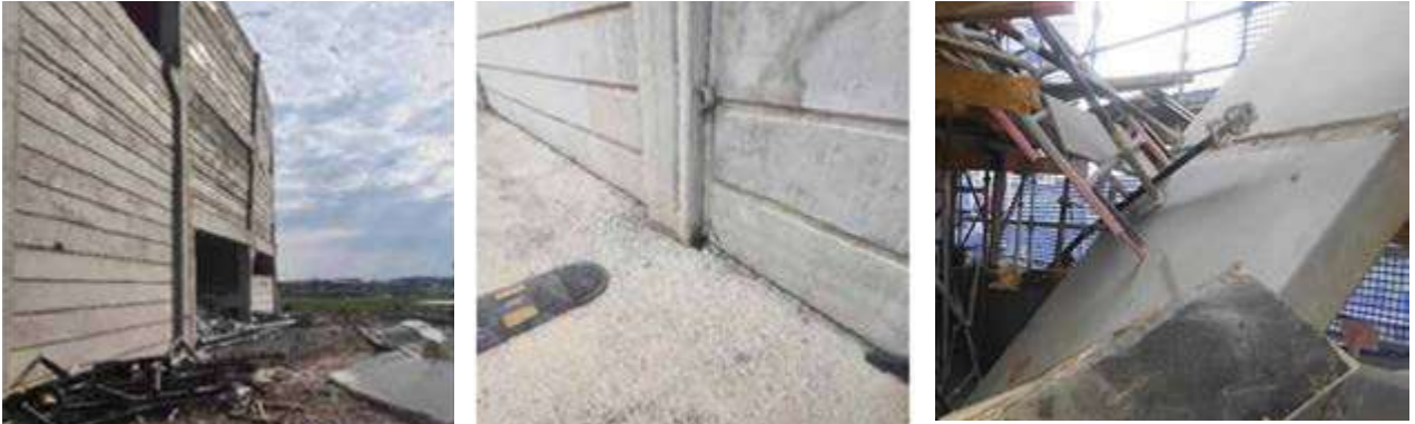
FOTOĞRAF 15. Deprem Etkileri Nedeniyle Oluşan Prefabrik Cephe Hasarı (Yüksel vd., 2023)
